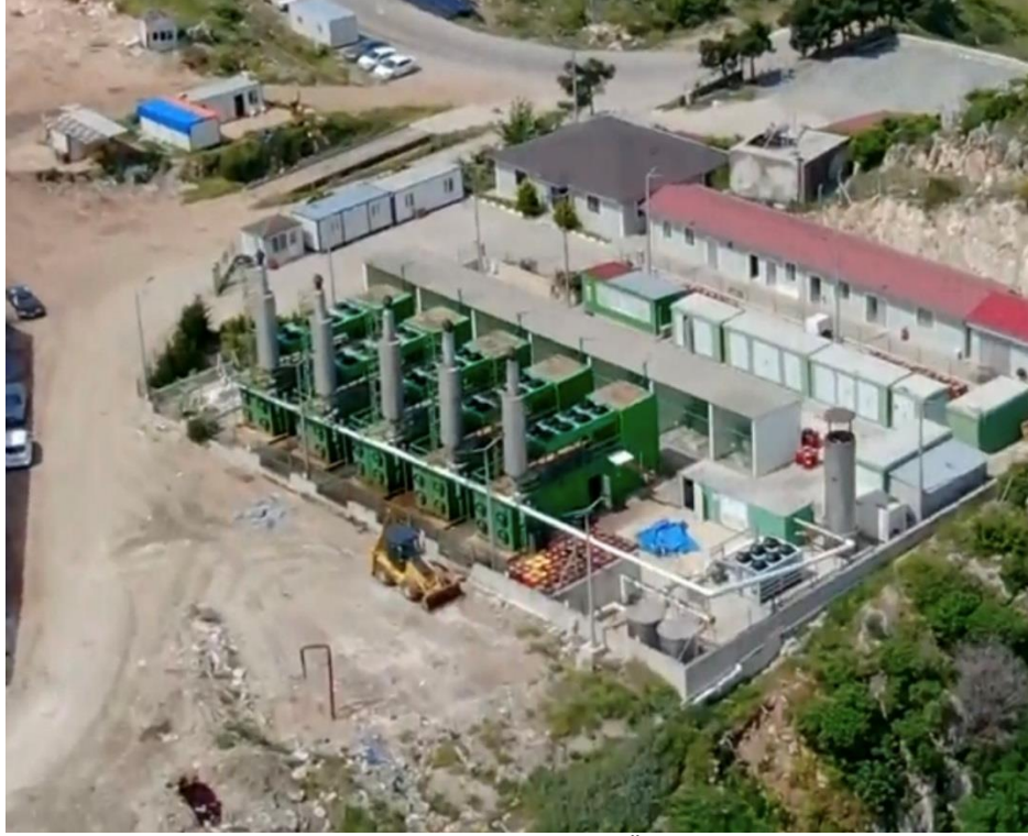
Çöp Gazından Elektrik Enerjisi Üretimi Tesisi
